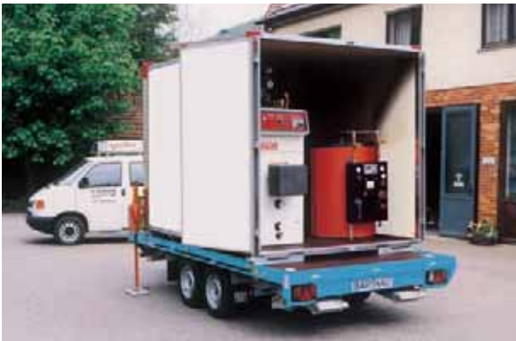
Multiplex-Container als mobile Heizung, für streßfreie Reparaturen wird die Heizung aus dem abgesetzten Container überbrückt.
